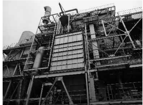
ジャパンファームバイオマス発電所 (2015年5月運転開始・鶏糞発電・垂水市)
