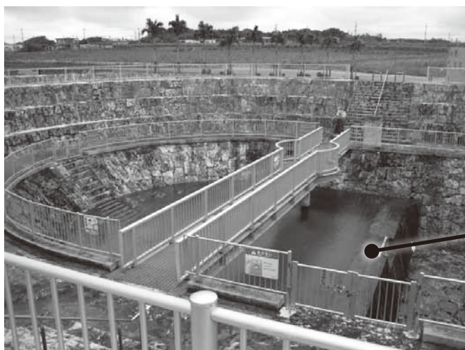
福里地下ダムの敷地内に建設されている水位水質観測用の地上露出部分。地下ダム見学施設を兼ねている。地下水が止水壁によって堰き止められている様子が、地上から観察することができる。止水壁左側が上流であり、満水となった地下水は止水壁の天端を越流している。
